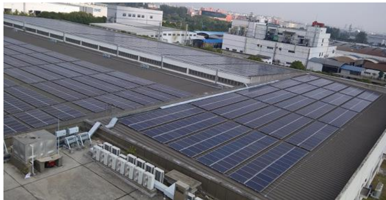
Wuxi Fuji Electric FA Co., Ltd.
