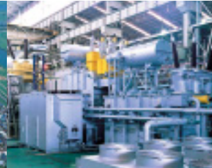
Transformer Rectifier Units
