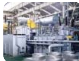
Transformer Rectifier Units
